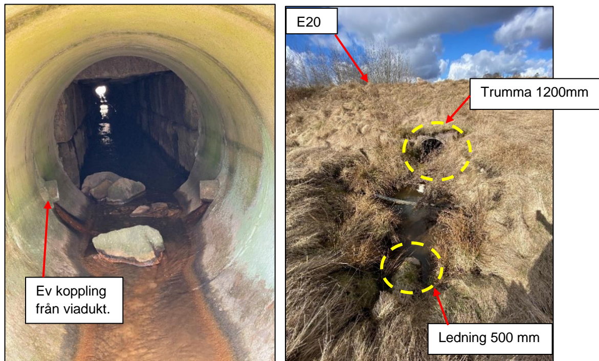
Figur 14. Betong trumma under E20, samt koppling till ledning, 500mm.
