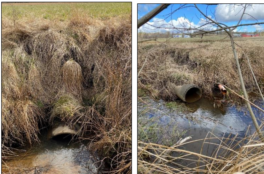
Figur 15. Utloppet till dike i öster från Trafikverkets ledning BTG 500 mm.
