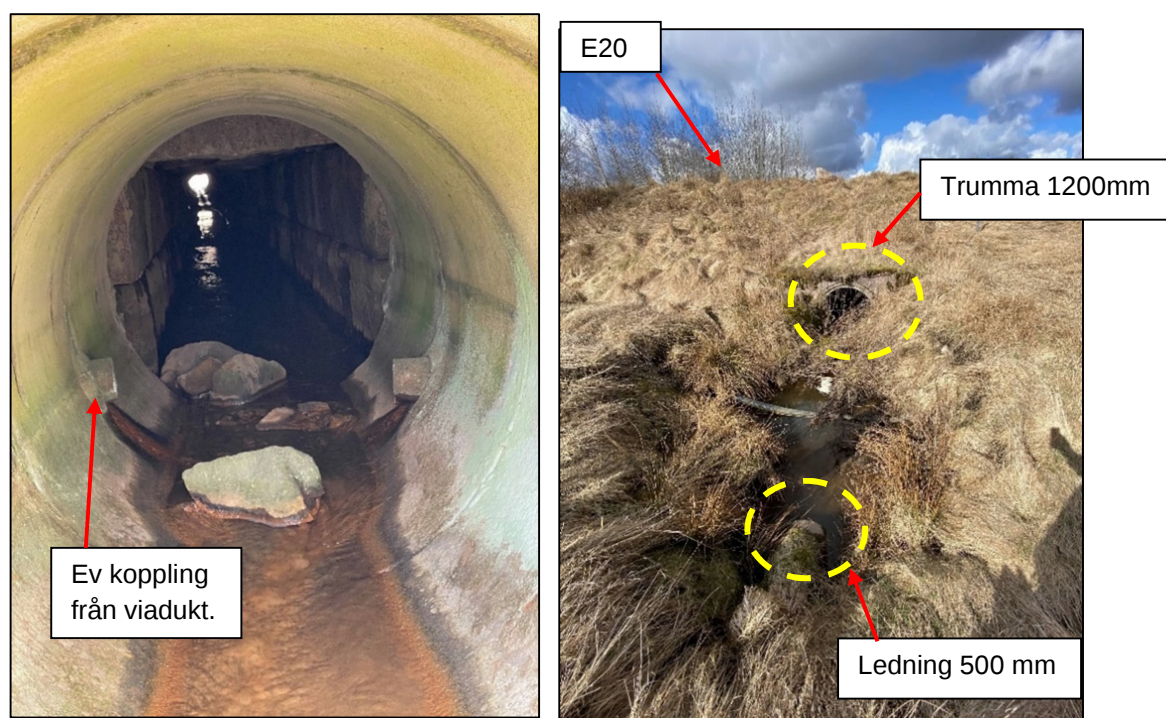
Figur 11. Trumma i betong under E20, samt koppling till ledning, 500 mm.
