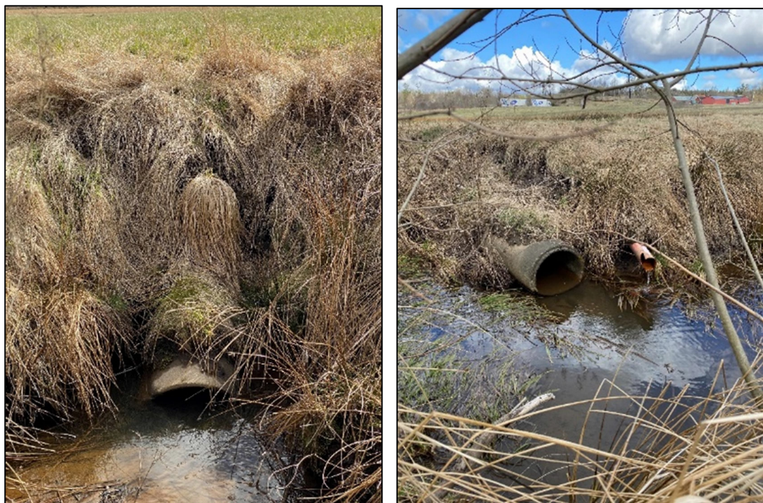
Figur 12. Utloppet till dike i öster från Trafikverkets ledning BTG 500 mm. Oklart om detta utlopp fortfarande används.
