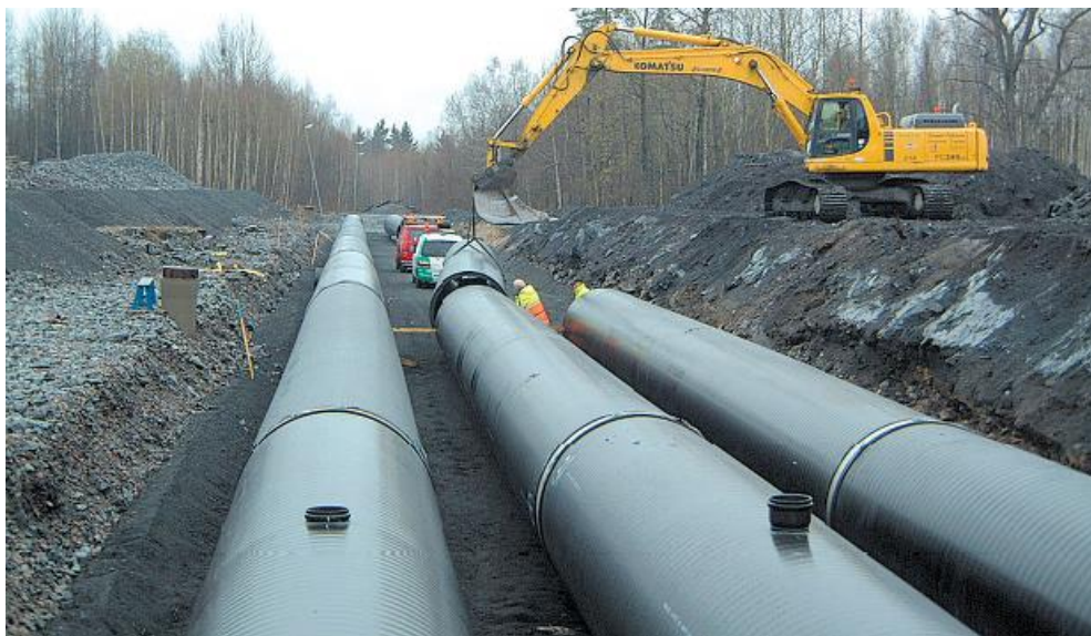
Figur 14. Dagvattenmagasin av Weholite dubbelväggiga lättviktsrör, polyeten. Källa: www.kwhpipe.se
