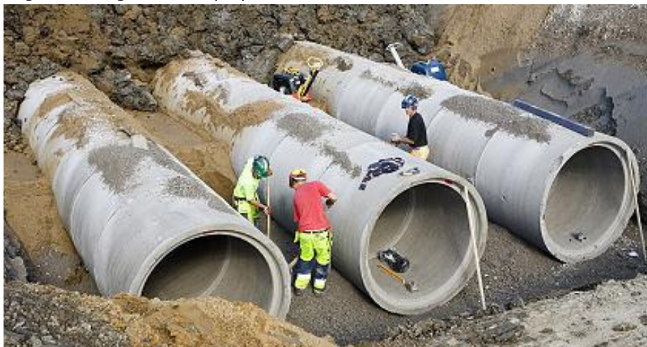
Figur 15. Dagvattenmagasin av betongrör Källa: www.steriks.se .
