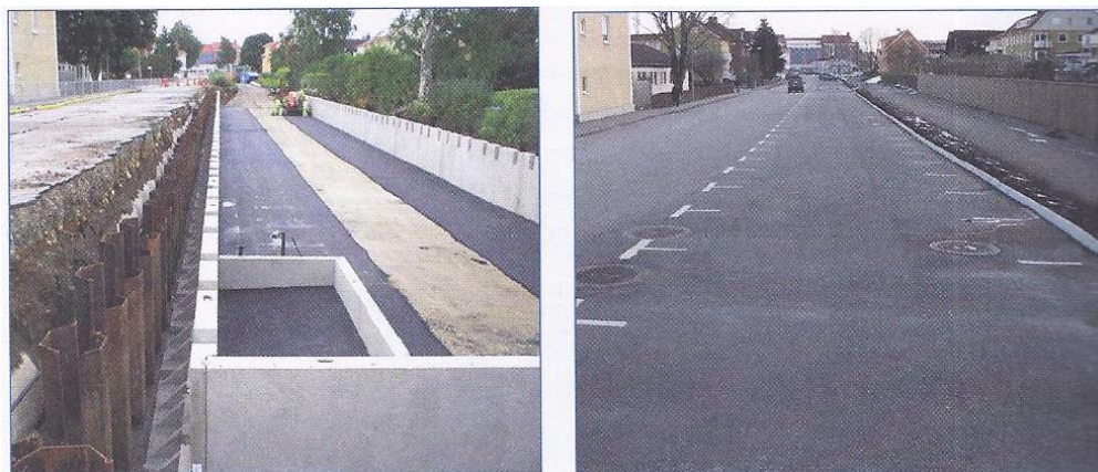
Figur 16. Plastgjutet dagvattenmagasin som är beläget under en parkeringsyta. Foto: Malin Engström. Källa: Svenskt vattens publikation P105: Hållbar dag- och dränvattenplanering.
