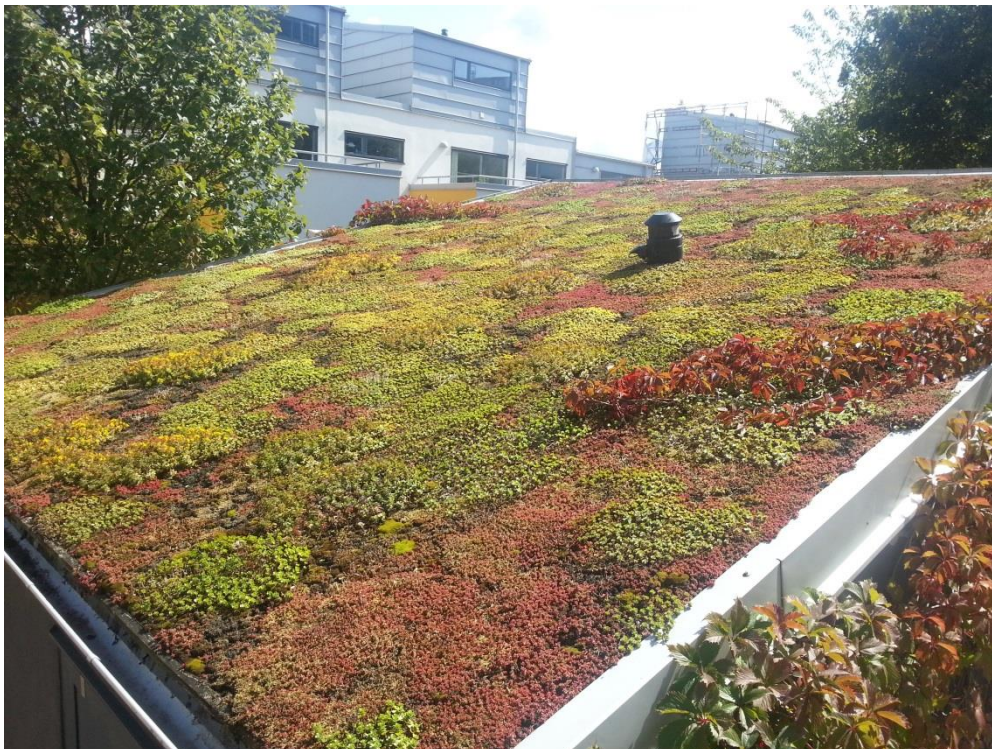
Figur 1. Grönt tak i västra hamnen, Malmö. Foto: Ramböll
